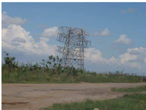
Torre de alta tensión
